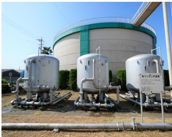
中央配水場（急速ろ過機、配水池）
