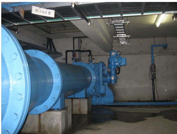
師勝配水場（場内配管）
