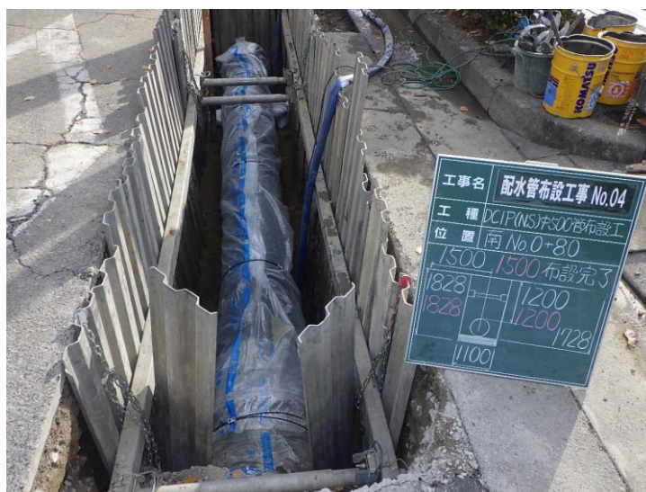
配水管布設工事（ダクティル鑄鉄管NS形継手口径500mm）
