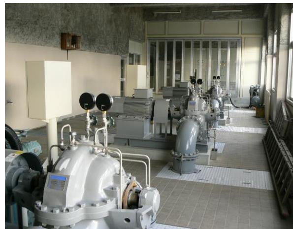
中央配水場（ポンプ設備）
