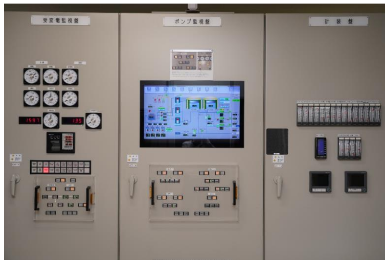
水道監視装置
