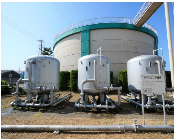
中央配水場（急速ろ過機、配水池）
