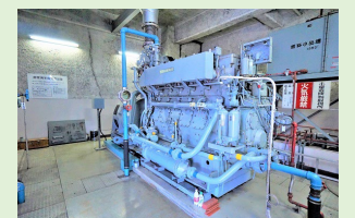
自家発電機(師勝)
