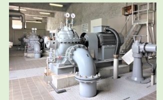
配水ポンプ(中央)
