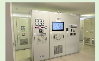
電気計装設備(中央)
