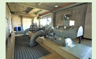
配水ポンプ(師勝)
