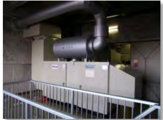
写真 4-7 自家発電機（師勝配水場）
