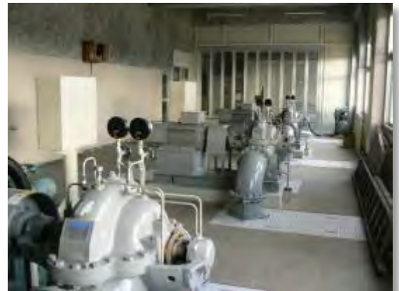
写真 4-27 配水ポンプ(中央配水場)
