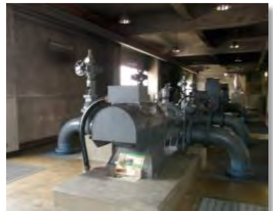
写真 4-5 ポンプ(師勝配水場)
