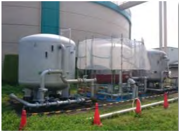
写真 4-2 除マンガノろ過機(中央配水場)
