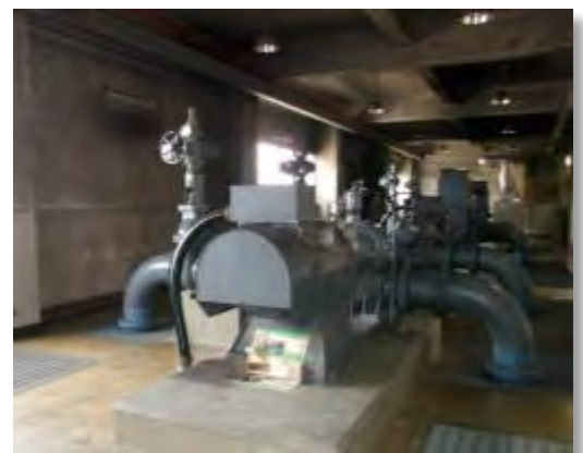
写真 4-5 ポンプ(師勝配水場)
