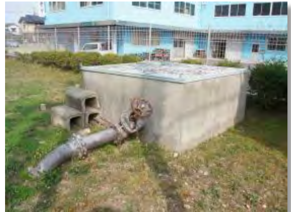
写真 4-1 水源（中央配水場）
